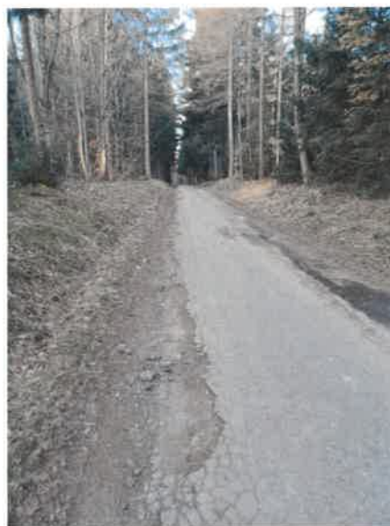
État actuel de la chaussée
